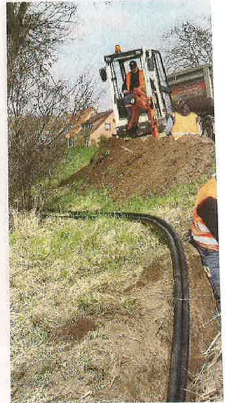
Anschluss an die Datenautobahn: Für Vollbüttel werden von der Telekom z
